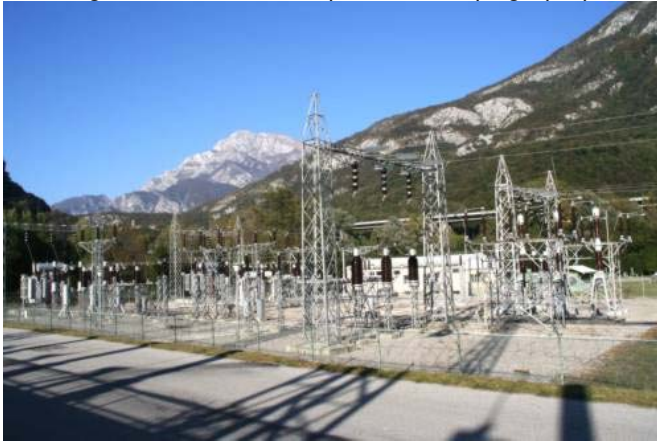
Figura 3 - Veduta dell'impianto di Somplago (UD).
